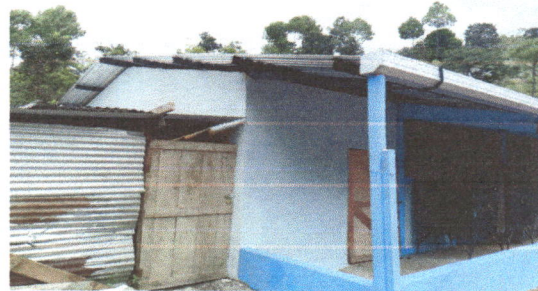
Foto 10: El levantado de muro de block de piedra 0.20*0.40*0.15 clase B expuesto para nivelar la pared de direccion fue cambiado en su totalidad
