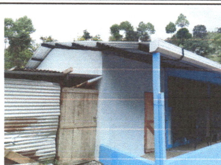
Foto 2: La estructura metalica con costanera de 2*4 chapa 16 y agregado de corredor con el proposito de nivelar fue cambiado en totalidad
